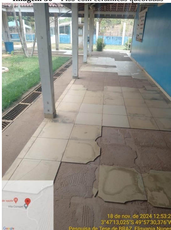
Imagem 36 – Piso com cerâmicas quebradas
